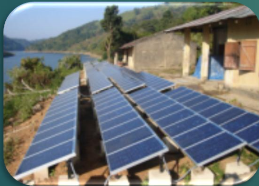
Solar PV: 200 MW
